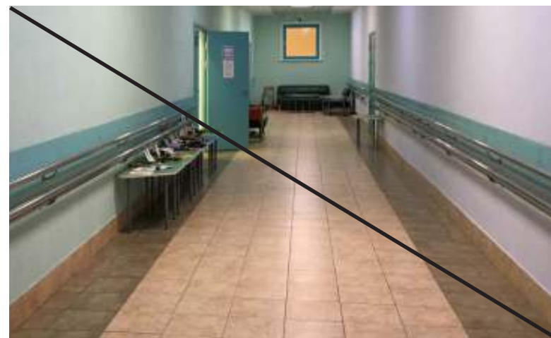
Плохо Керамогранитная плитка с крупными швами
