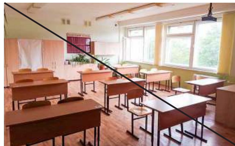
Плохо Линолеум под дерево
