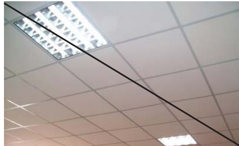
Плохо Открытые направляющие
